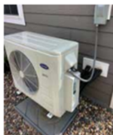
CLS Pompe à chaleur
